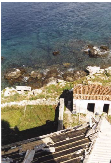
Auch hier wütete der Sturm ganz ordentlich, hinterließ starke Gebäudeschäden.
